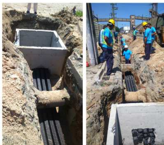
CHEGADA EM CAIXA DE PASSAGEM
